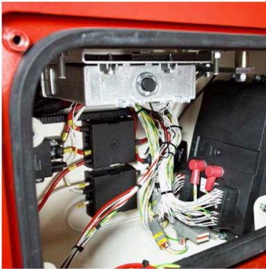
Электрический шкаф легко доступен.
